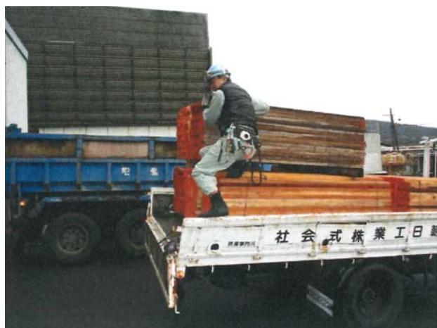
【荷台移動時の状況】
